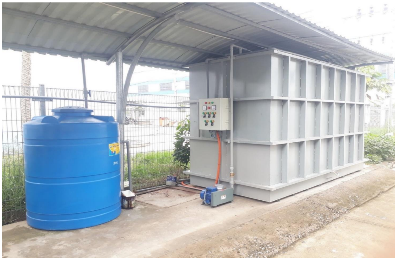
Module hệ thống xử lý nước thải Công nghiệp và y tế
